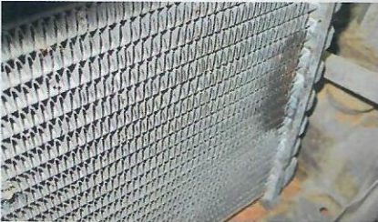
Die Kühler neigen im Laufe der Jahre zu Haarrissen und Undichtigkeiten
