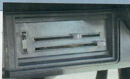
Beschädigte Bowdenzüge, Thermostate und kaputte Wärmetauscher sind häufig zu finden
