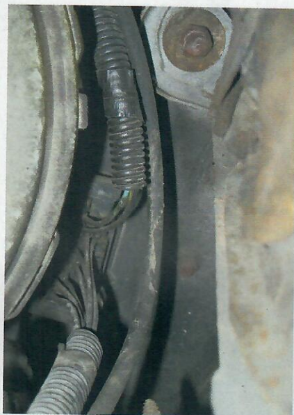
Elektrikprobleme gibt es ab und zu an der Durchführung vom Motor- zum Innenraum
